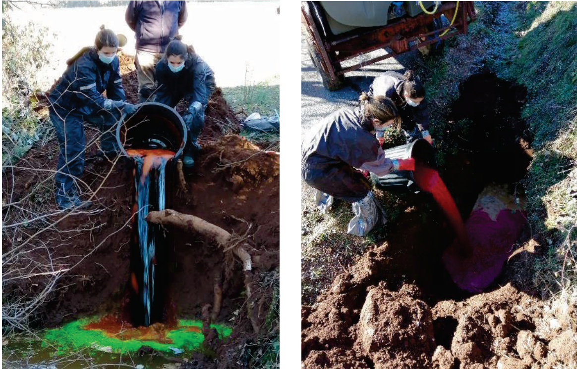
Figure 66 : Vues des injections dans le ruisseau en contrebas de la RD911 (à gauche) et au hameau de l'Hermet (à droite) (clichés Calligée – 19/01/2021)
